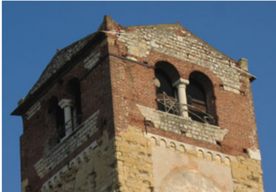
Degrado della parte sommitale del campanile: particolare dei timpani e della cella campanaria
