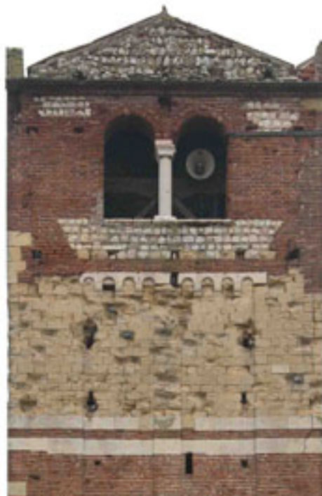
Particolare delle lesioni che interessano gli spigoli del campanile
