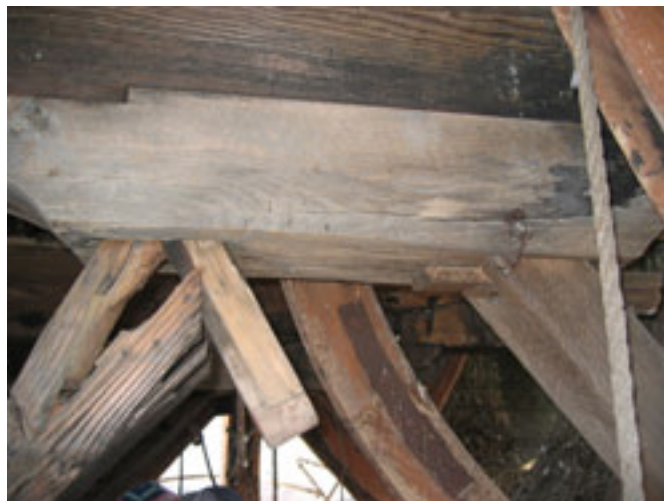
Castello campane: particolare di un elemento ligneo ammalorato
